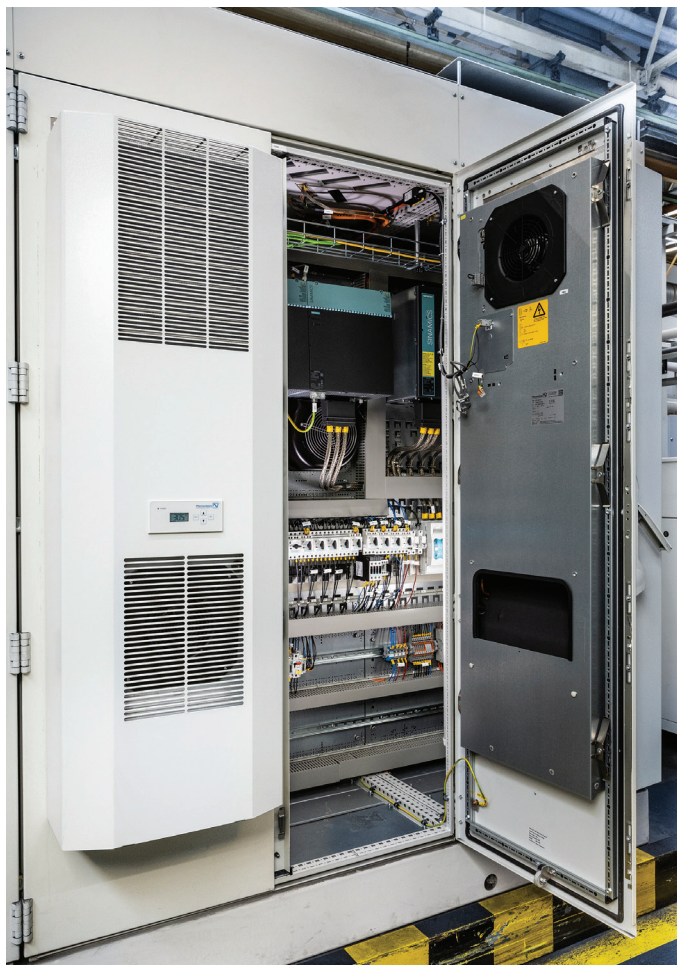
Bild oben: Geöffneter Schaltschrank mit zwei in die Türen teilversenkten X-Series Kühlgeräten DTI 6X1E.
